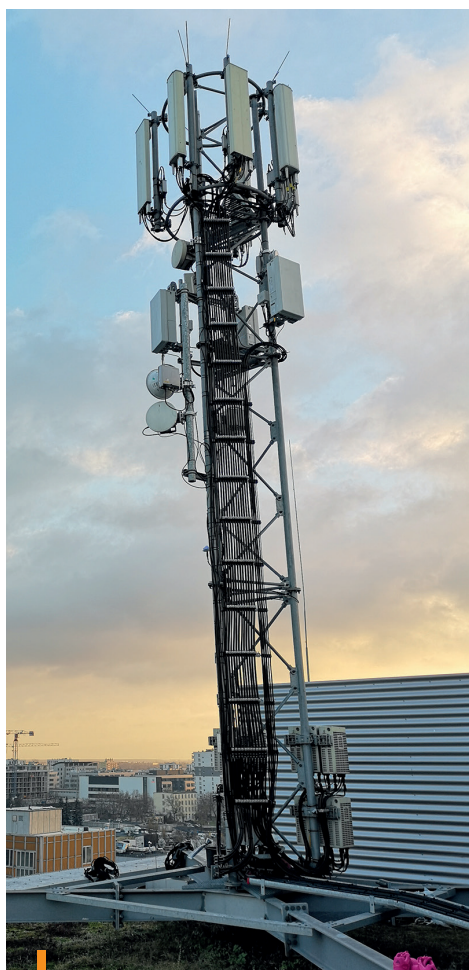
Stacja bazowa T-Mobile
